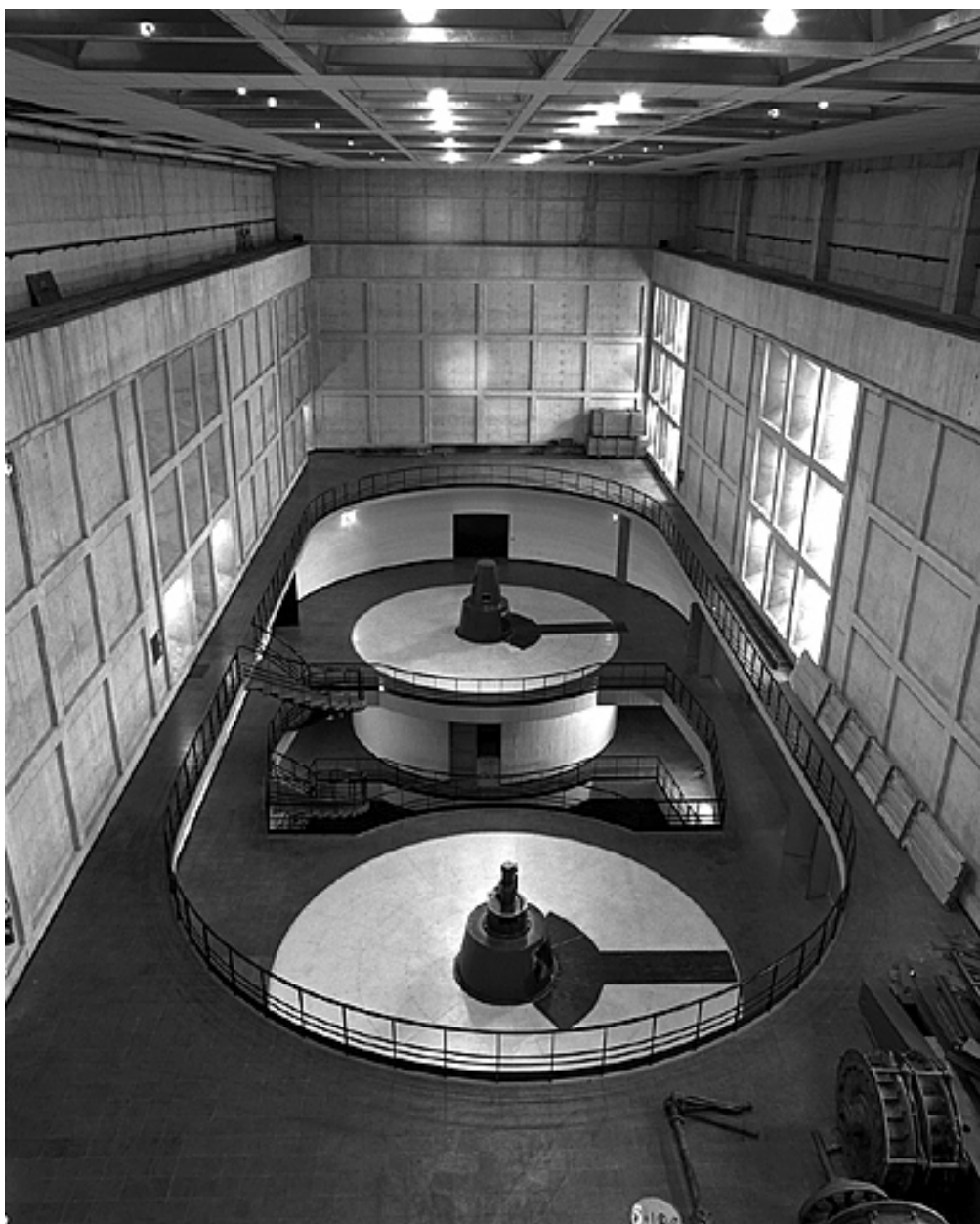
Intérieur de la centrale.
