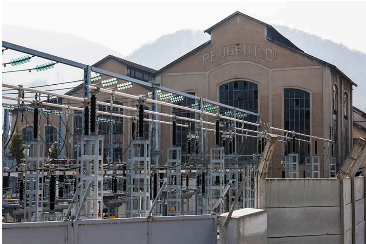
La centrale thermique.
