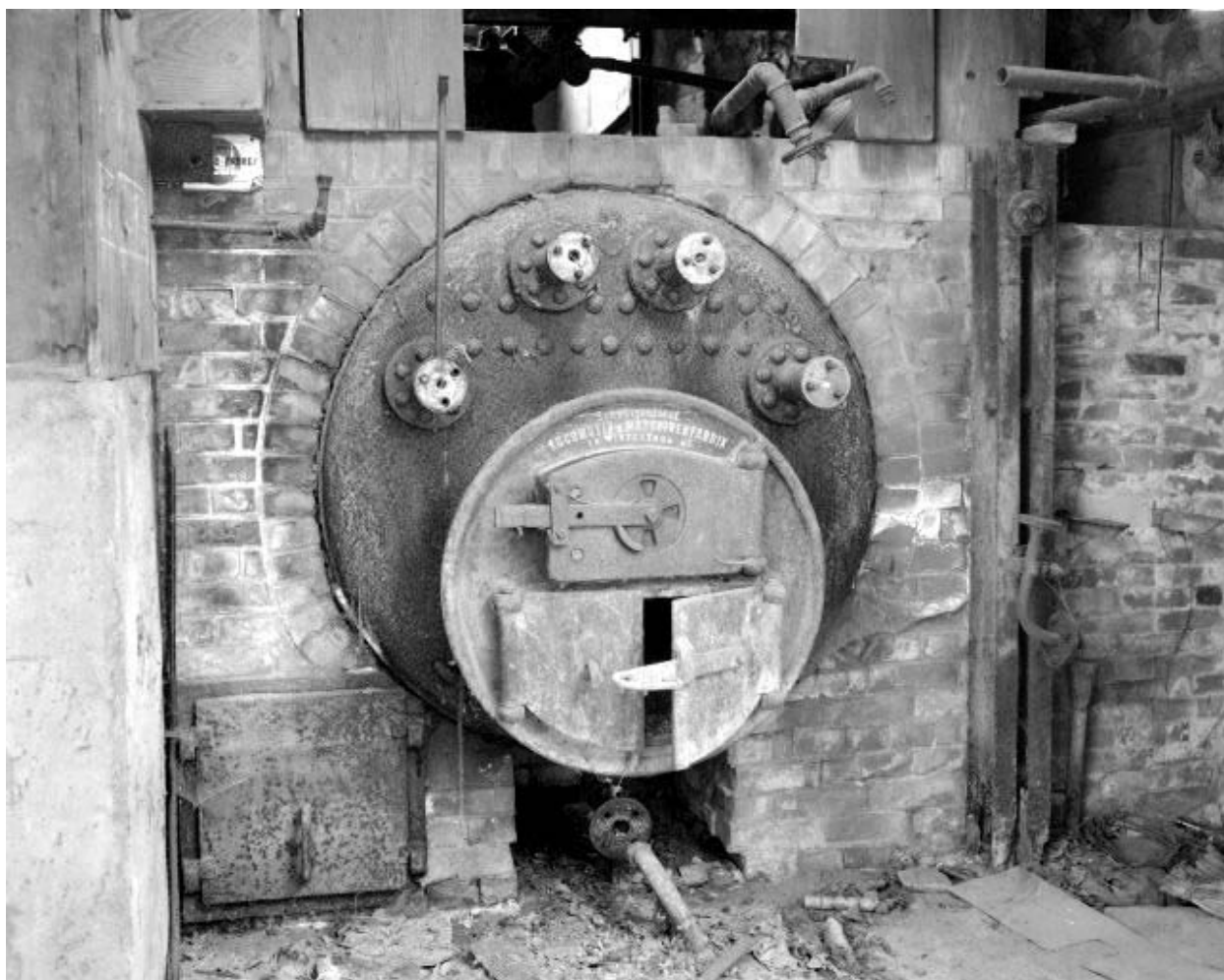
Intérieur de la chaufferie (Q) : chaudière.
