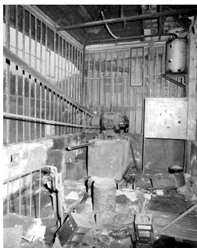
Moteur électrique Patay. Phot. Yves Sancey IVR43_19943901565X
