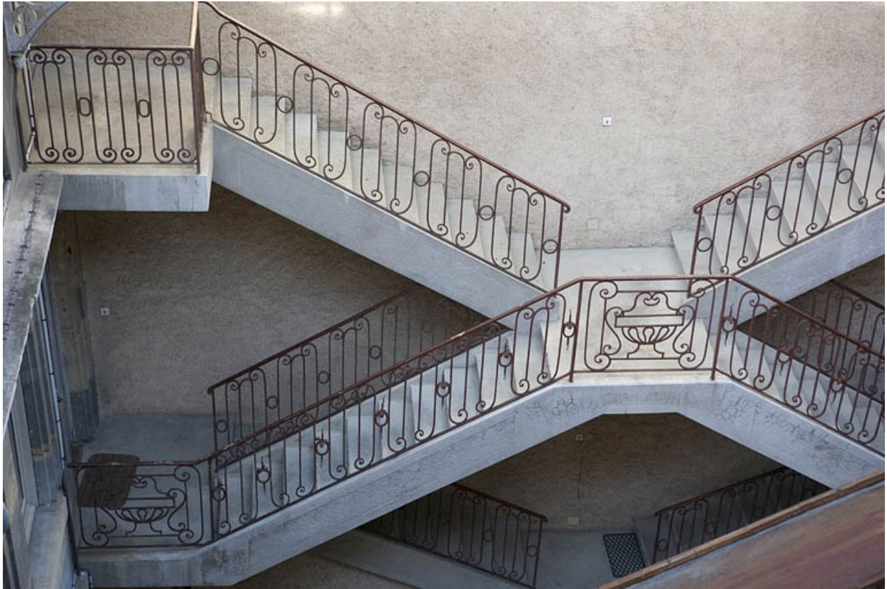
Détail de la rampe en fer forgé de l'escalier à cage ouverte, depuis la parcelle voisine.
