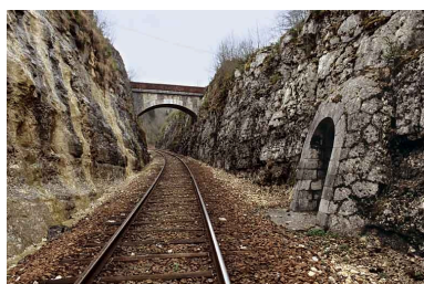
Vue d'ensemble de la tranchée, depuis le côté Andelot-en-Montagne (nord). A droite le deuxième abri, à l'arrière-plan le pont au PK 094.061. Phot. Yves Sancey IVR43_20053900909ZA
