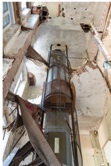
Ascenseur de l'escalier ouest, vue d'ensemble après l'effondrement des planchers. Phot. Pierre-Marie Barbe-Richaud IVR26_20195800573NUC4A
