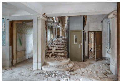
Hall d'entrée au rez-de-chaussée, vue en direction de l'ouest. Phot. Pierre-Marie Barbe-Richaud IVR26_20195800570NUC4A
