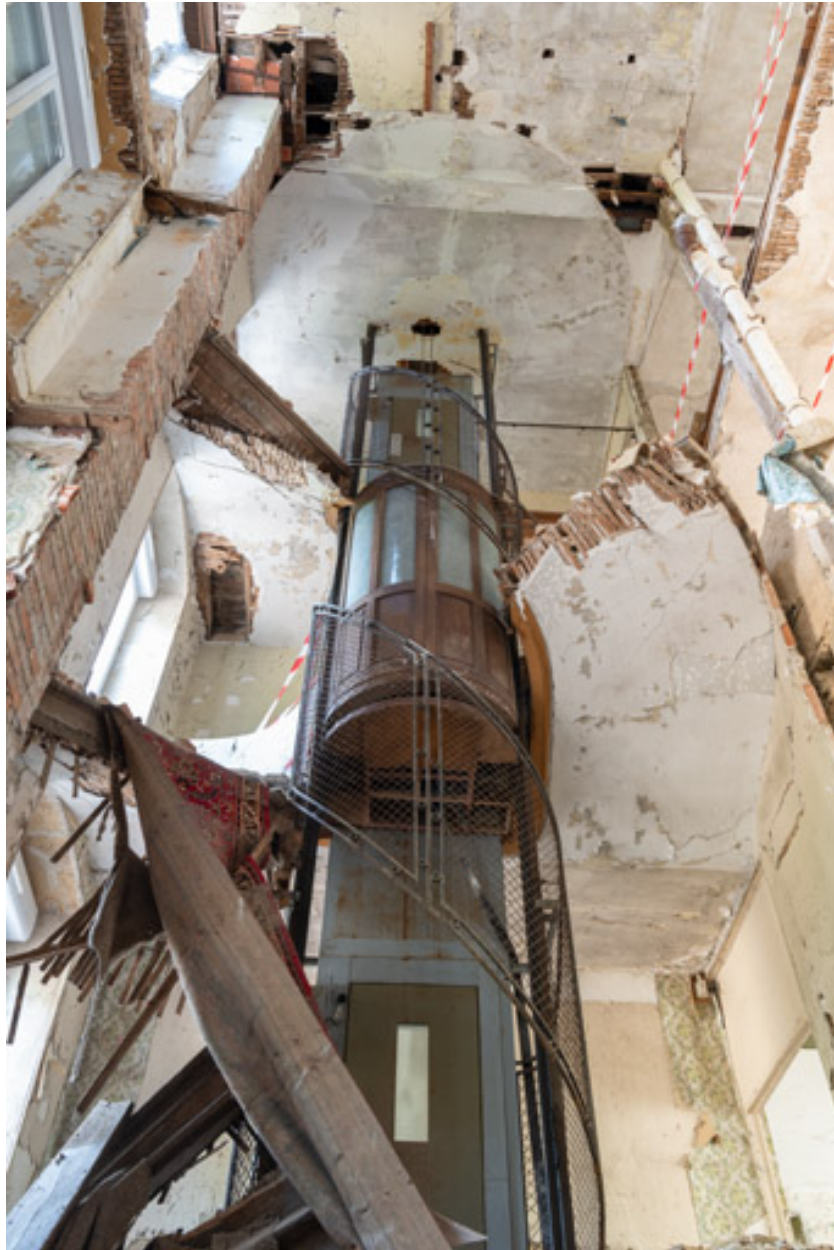
Ascenseur de l'escalier ouest, vue d'ensemble après l'effondrement des planchers.
