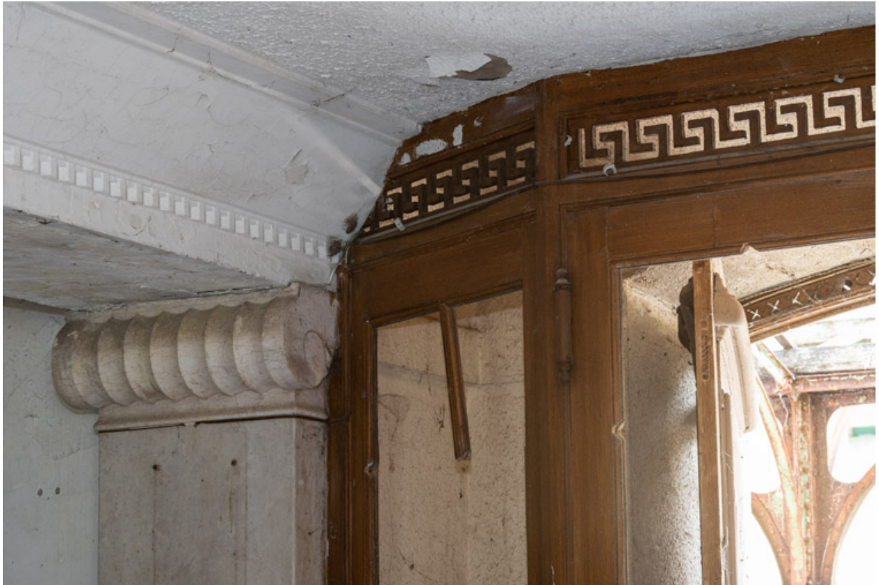
Décor de l'huissierie du sas de l'entrée côté avenue, frise ajourée de grecques.
