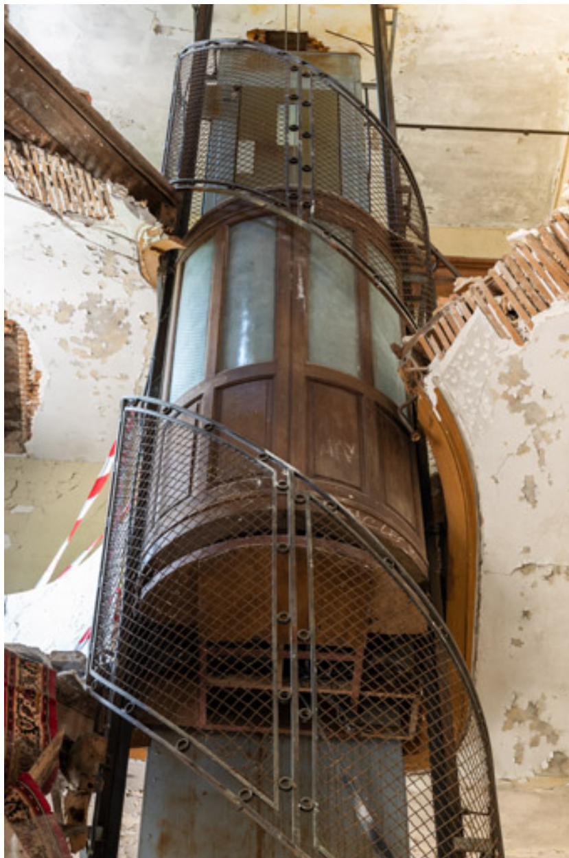
Ascenseur de l'escalier ouest, cabine.
