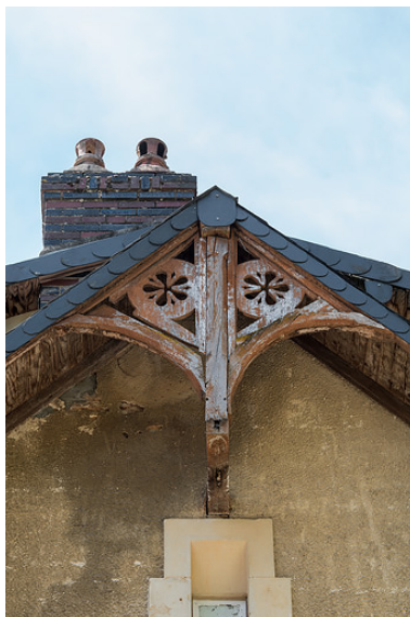
Pignon nord-est, éléments de charpente apparente (sous-arbalétriers, cercles). Phot. Pierre-Marie Barbe-Richaud IVR26_20195800673NUC4A
