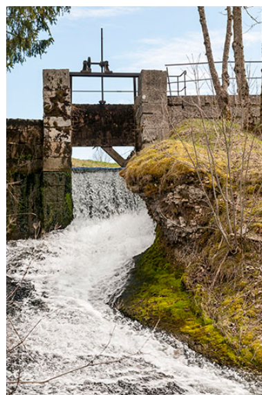
Vanne de décharge sur le Bief Rouge. Phot. Jérôme Mongreville IVR43_20162500264NUC4A
