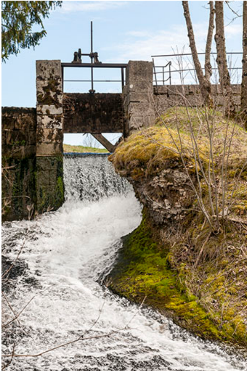
Vanne de décharge sur le Bief Rouge.
