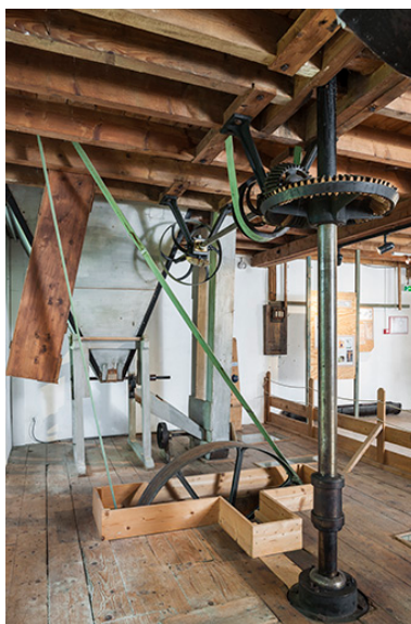
Deuxième étage. Système de transmission. Phot. Jérôme Mongreville IVR43_20162500273NUC4A
