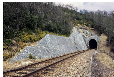
Tunnel des Frettes : vue d'ensemble côté La Cluse (sud). Phot. Yves Sancey IVR43_20053900683ZA
