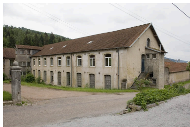
Vue de trois quarts de la réception et de l'atelier de rentrage. Phot. Jérôme Mongreville IVR43_20067000455NUCA
