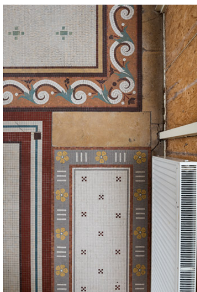
Seuil du couloir de jonction entre la villa (en bas) et le jardin d'hiver (en haut) avec l'agrandissement des années 1930-1940 (à gauche). Phot. Pierre-Marie Barbe-Richaud IVR26_20195800600NUC4A
