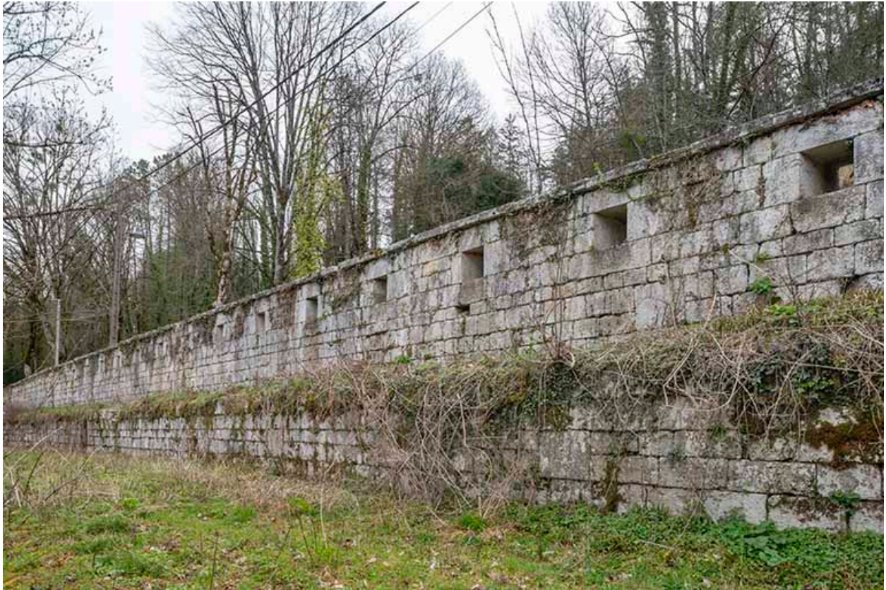
Face interne du rempart est, au niveau du bastion (disparu) des Jésuites.
