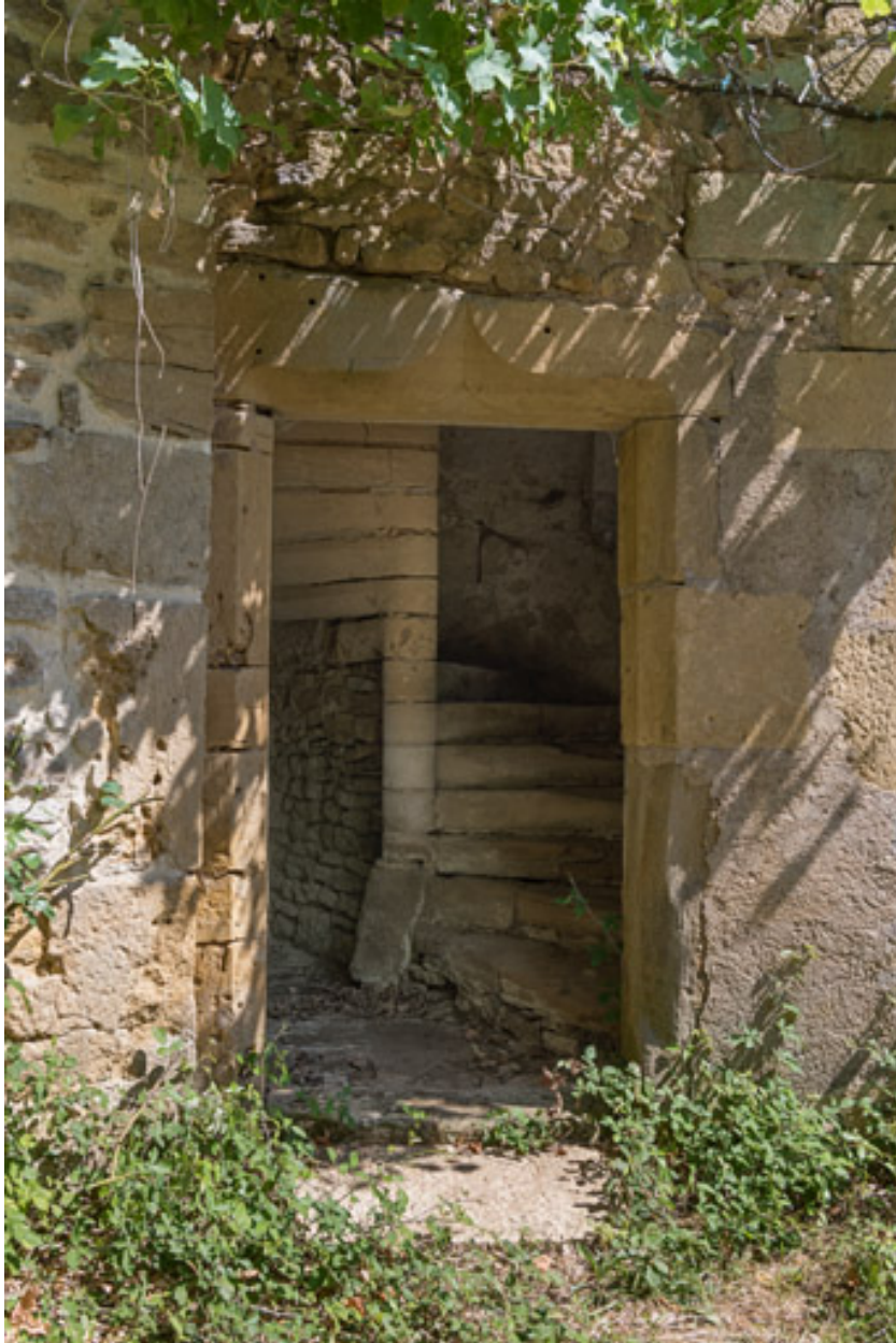
Vue de l'escalier à vis et de sa porte d'accès, avec son linteau orné d'une accolade
