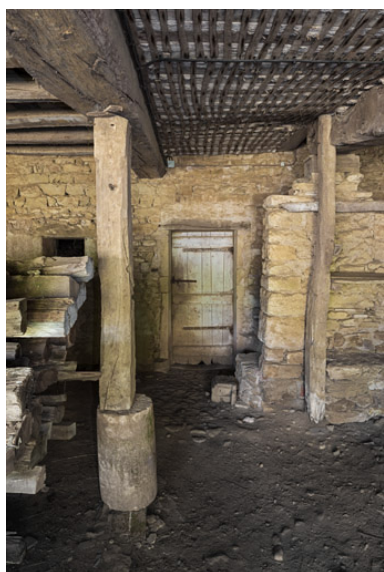
Un fenil a été aménagé au-dessus du hangar. Son plancher est constitué de solives en bois, entre lesquelles s'intercalent des bottes de paille. Le tout est couvert de lattes. Phot. Pierre-Marie Barbe-Richaud IVR26_20197100204NUC4A
