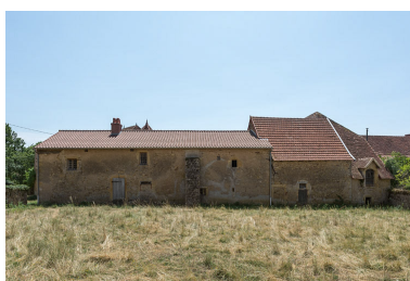
Façade postérieure de la demeure et des bâtiments annexes, depuis le jardin, au nord. Une rupture de maçonnerie, à gauche du contrefort, indique que l'habitation a été vraisemblablement construite en deux phases. Phot. Pierre-Marie Barbe-Richaud IVR26_20197100183NUC4A
