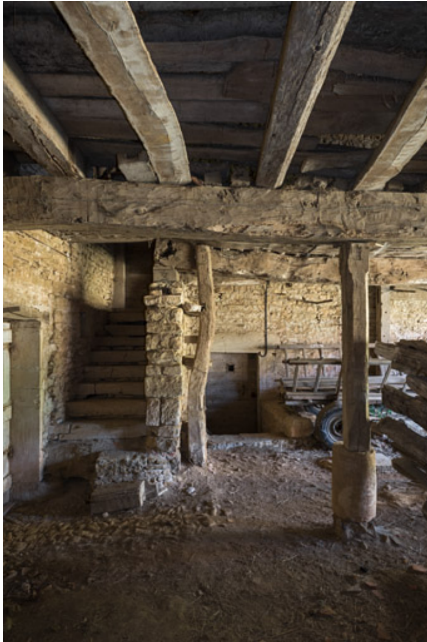
Hangar à droite de la remise. Au fond, deux petits escaliers permettent l'accès à un cellier pour l'un et à une cave semi-enterrée pour le second.
