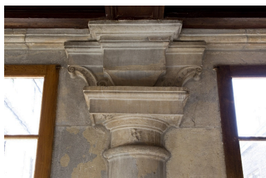
Logis principal, intérieur du portique : détail d'une zapata de face. Phot. Yves Sancey IVR43_20112502765NUC2A
