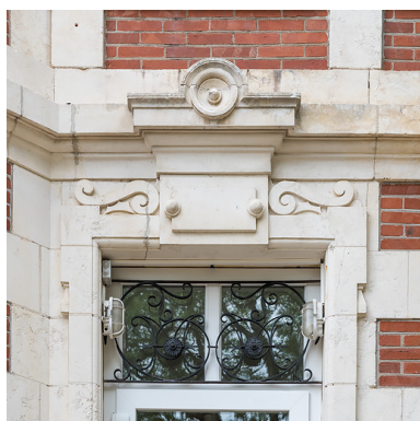
Porte d'entrée, détail du décor en pierre sculptée (disque et table, volutes, gouttes). Phot. Pierre-Marie Barbe-Richaud IVR26_20195800653NUC2A
