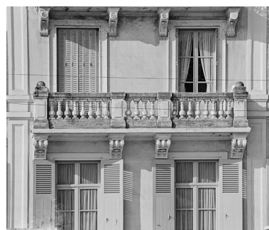
Balcon du premier étage des baies centrales de la façade nord du corps principal, vue de 1984. Phot. Michel Thierry IVR26_19845800005X
