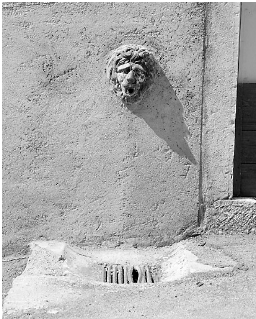
Bâtiment 3 rue Etienne Dolet : point d'eau.
