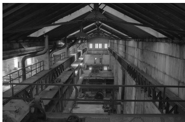
La salle des pompes photographiée depuis le pont roulant. Phot. Frédéric Pillet IVR26_20007100389Z
