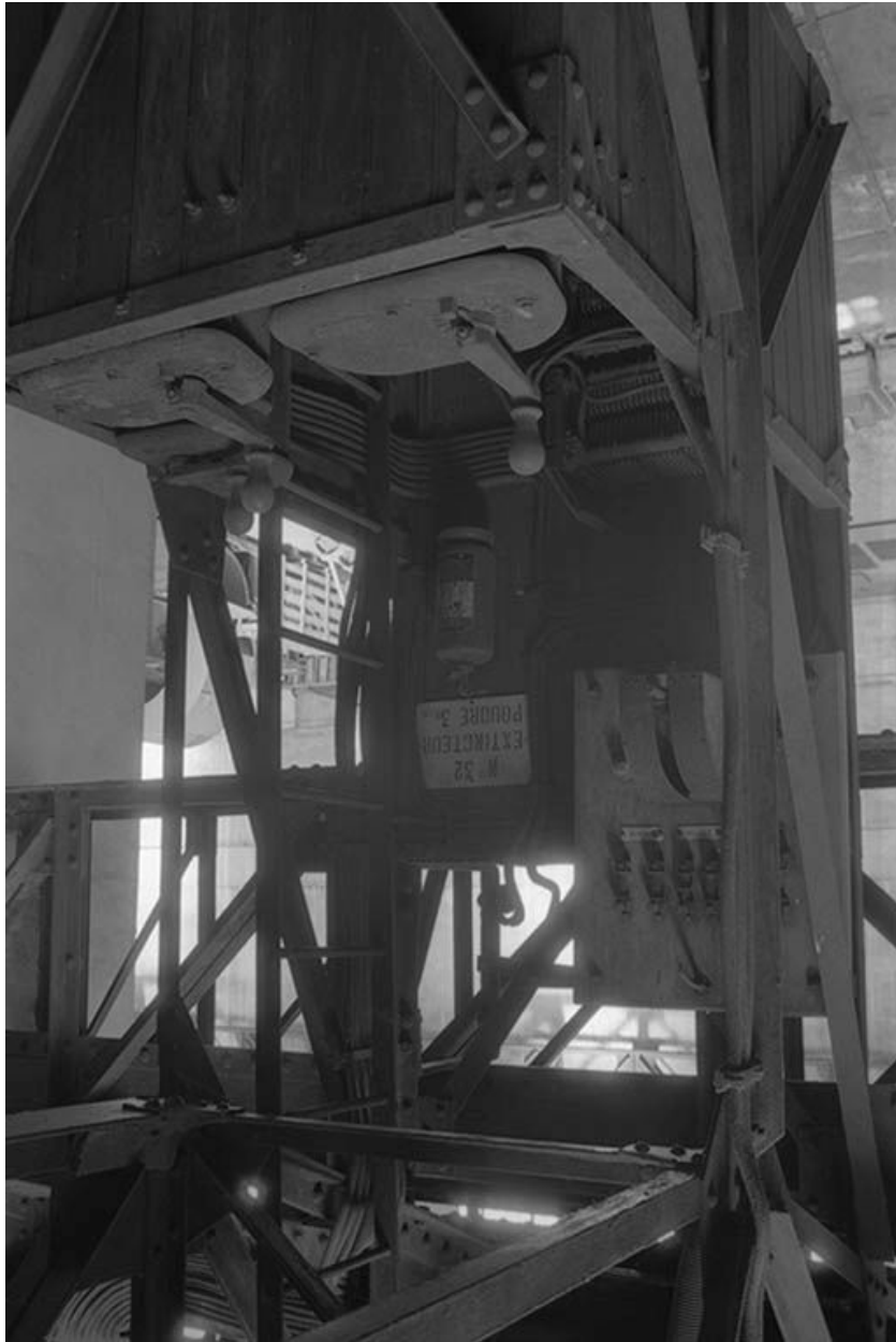
Le poste de commande du pont roulant de la salle des pompes.
