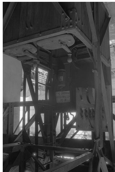
Le poste de commande du pont roulant de la salle des pompes. Phot. Frédéric Pillet IVR26_20007100390Z
