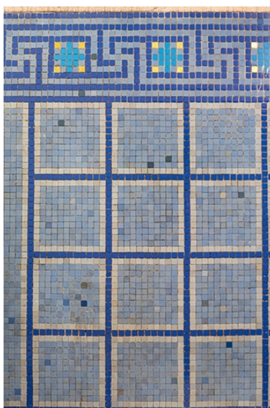
Mur nord de la dernière cabine (actuellement, local de stockage) au rez-de-chaussée de l'aile ouest de la piscine. Phot. Jérôme Mongreville IVR43_20207000335NUC4A
