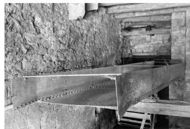
Conduite d'amenée. Phot. Laurent Poupard IVR43_19923901179Z
