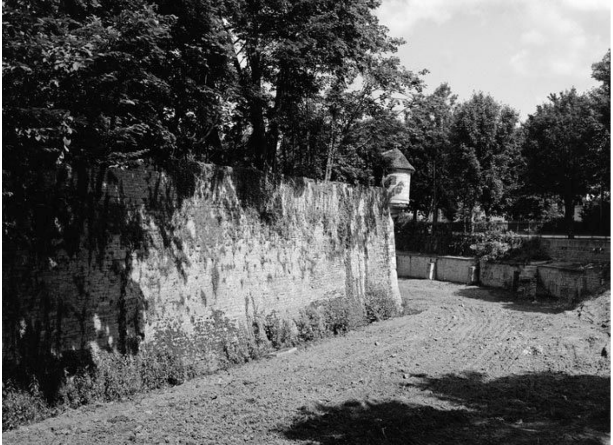
Bastion Notre-Dame, depuis le fossé : parapet et échauguette (1988).
