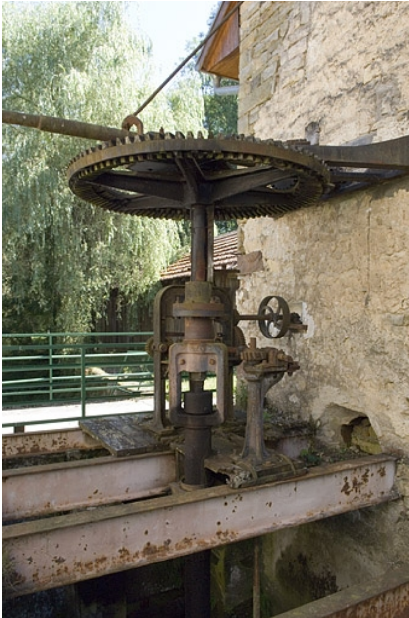
Turbine hydraulique. Partie supérieure de la transmission.
