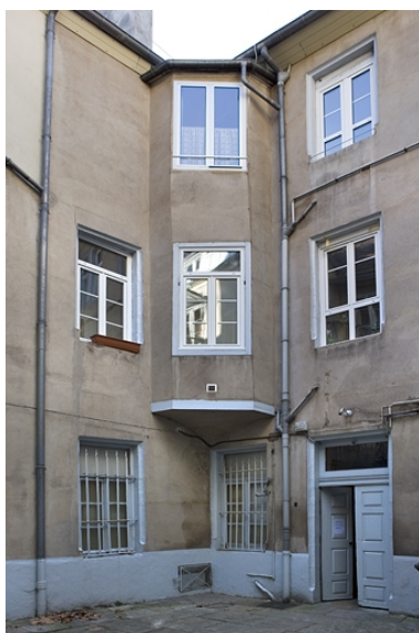
Détail des façades depuis le fond de la première cour. Phot. Yves Sancey IVR43_20082500263NUC2A
