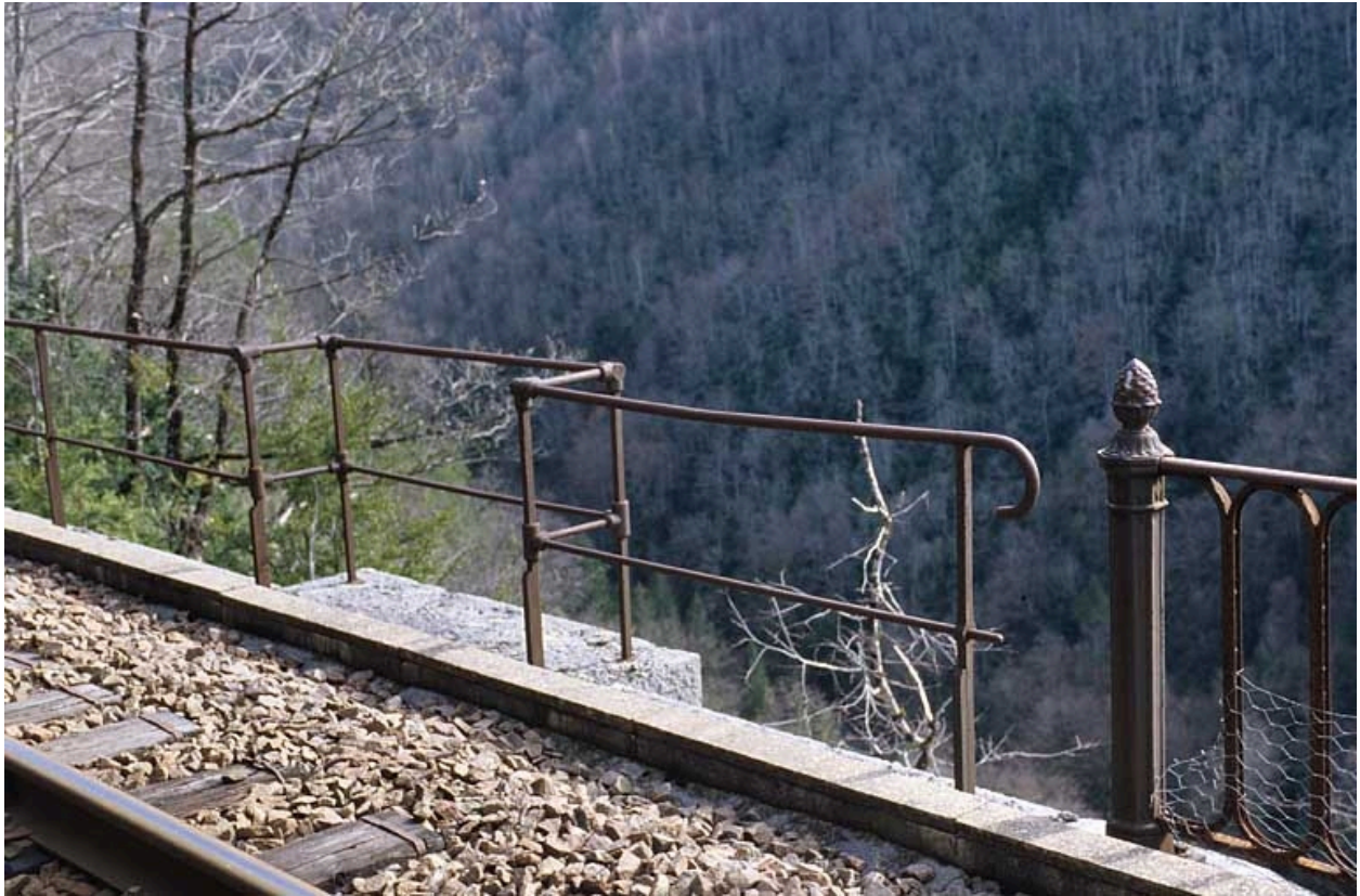
Garde-corps métalliques du mur (à gauche) et du viaduc (à droite), depuis la voie.
