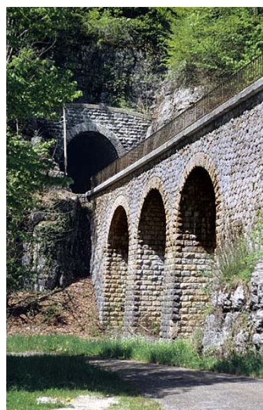
Viaduc et tunnel, depuis le chemin départemental n° 126 à l'est (côté Andelot-en-Montagne). Phot. Yves Sancey IVR43_20053900638ZA
