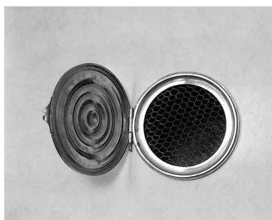
Bouche de chaleur de la cheminée, ouverte. Phot. Yves Sancey IVR43_20013900144X
