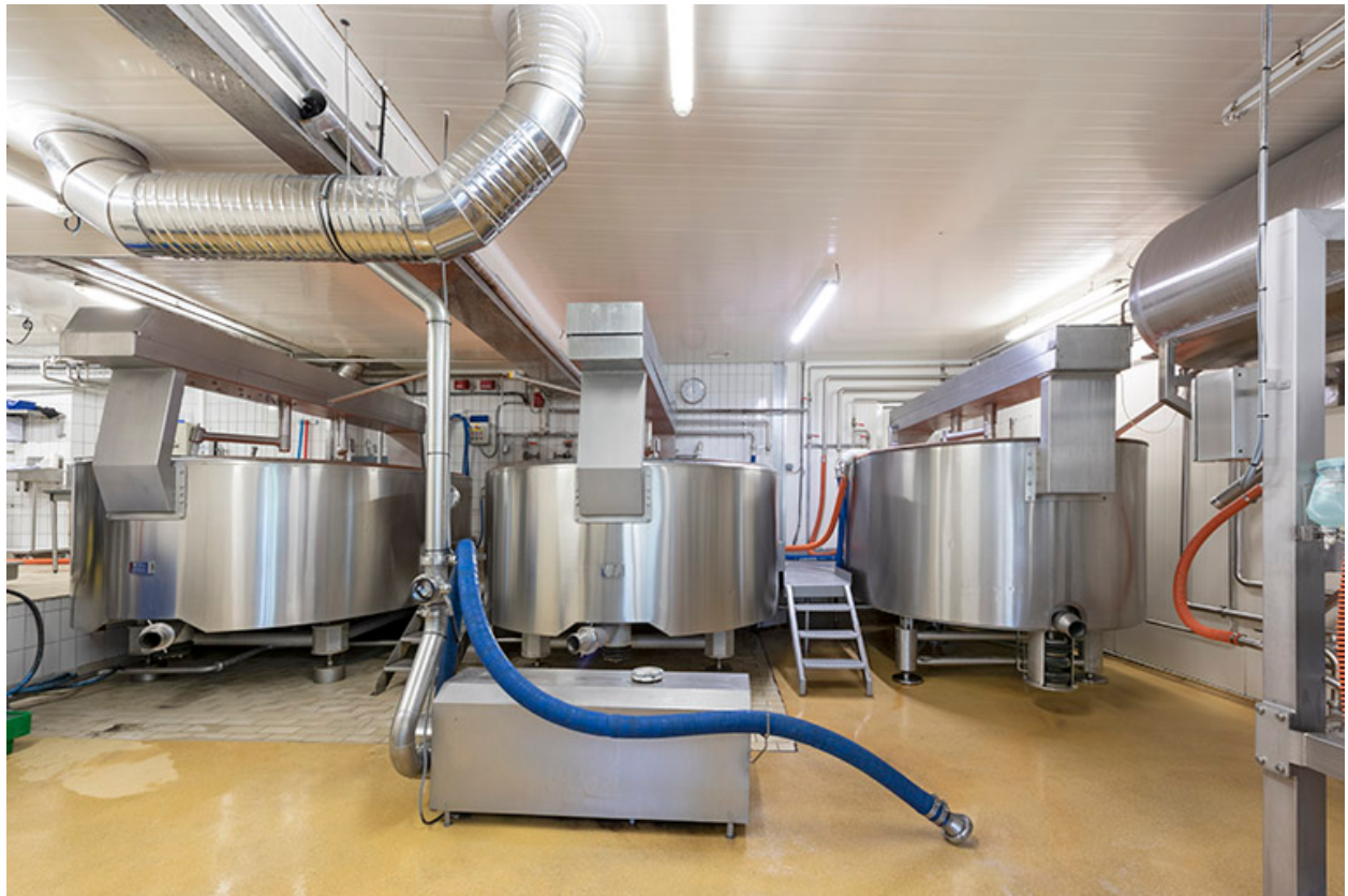
Intérieur de l'atelier de fabrication : les cuves.
