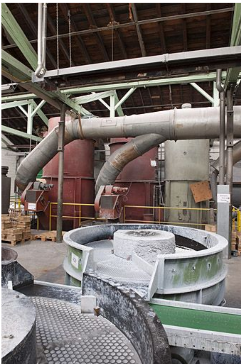
Atelier de polissage et chambre d'aspiration.
