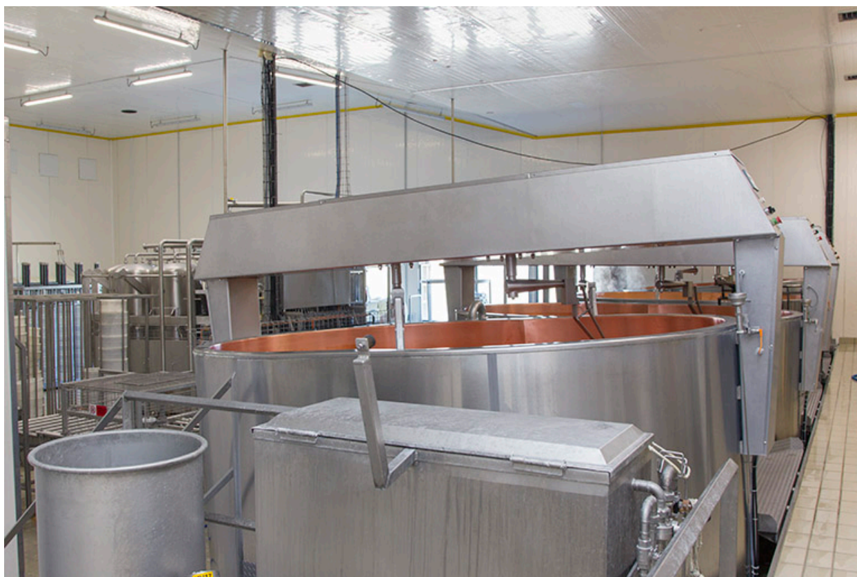
Atelier de fabrication : vue d'ensemble, avec les cuves au premier plan.
