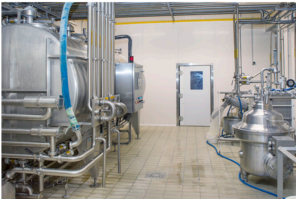
Salle de la station de lavage CIP.
