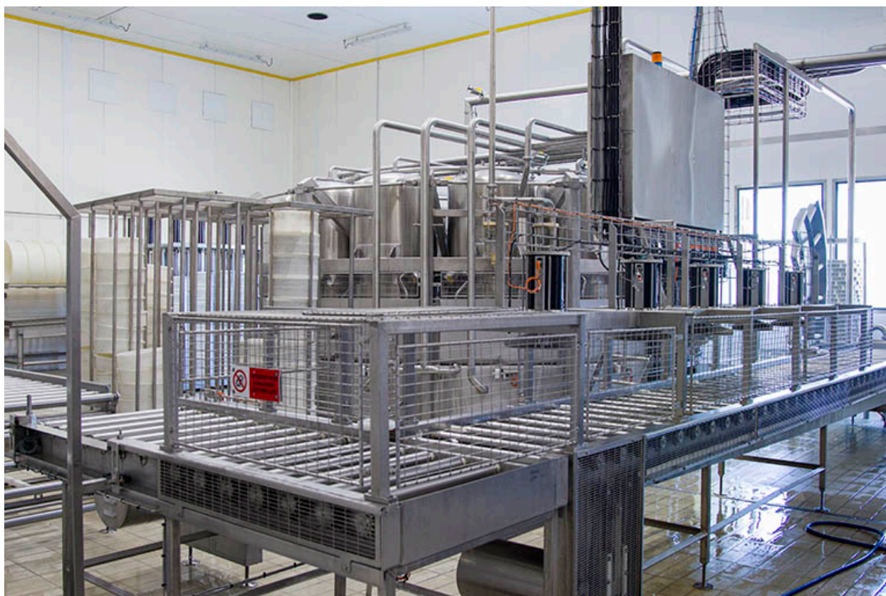
Atelier de fabrication : extrémité du convoyeur côté presse tournante.
