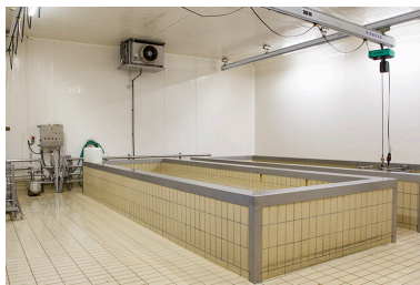
Atelier de saumurage : vue d'ensemble. Phot. Sonia Dourlot IVR43_20142500792NUC2A
