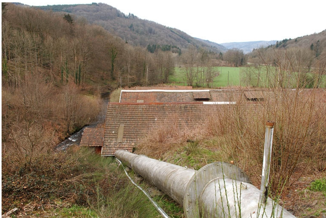
Conduite forcée de la centrale hydroélectrique.
