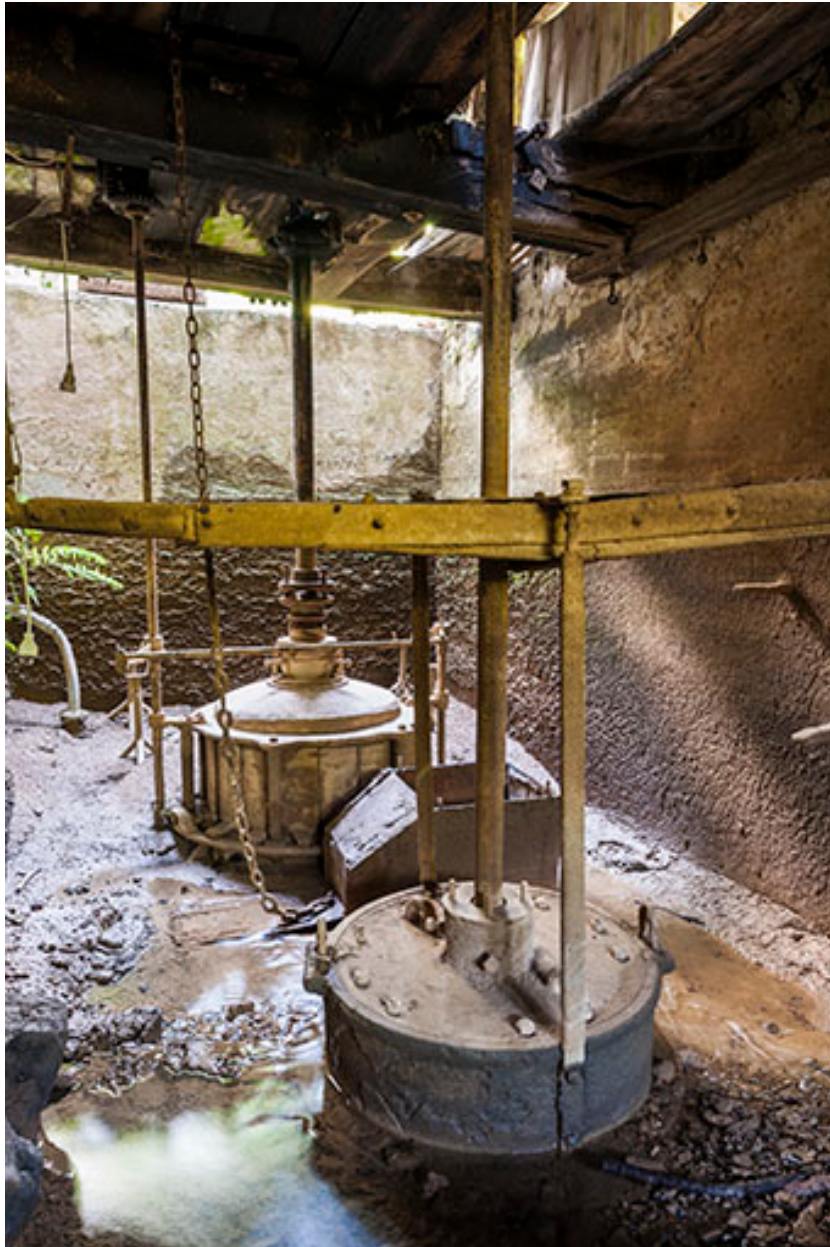
La chambre d'eau des turbines.
