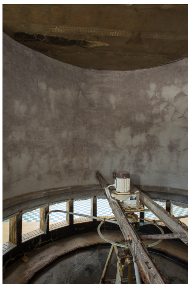
Salle des douches de pieds, asperseur à l'intérieur du cylindre de protection. Phot. Pierre-Marie Barbe-Richaud IVR26_20195800215NUC4A
