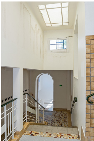
Escalier conduisant de la salle de pulvérisation des enfants au vestibule nord. Phot. Pierre-Marie Barbe-Richaud IVR26_20195800179NUC4A
