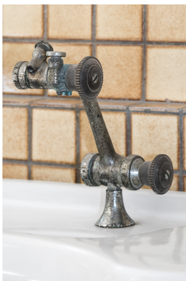
Salle de pulvérisation des enfants, robinet. Phot. Pierre-Marie Barbe-Richaud IVR26_20195800181NUC4A
