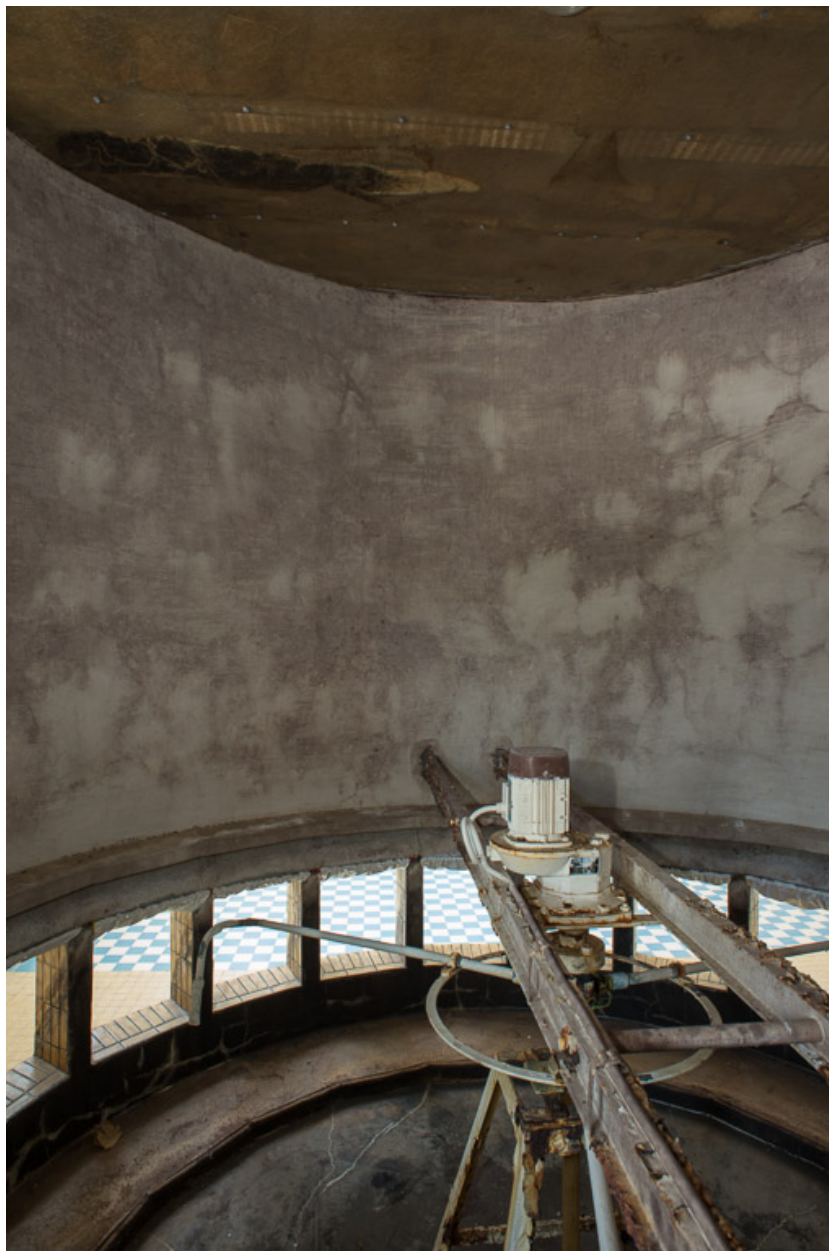
Salle des douches de pieds, asperseur à l'intérieur du cylindre de protection.
