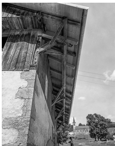
Ferme située au lieu-dit Le Pissoux : extrémité des arbalétriers. Phot. Dominique Humbert IVR43_19762500433X
