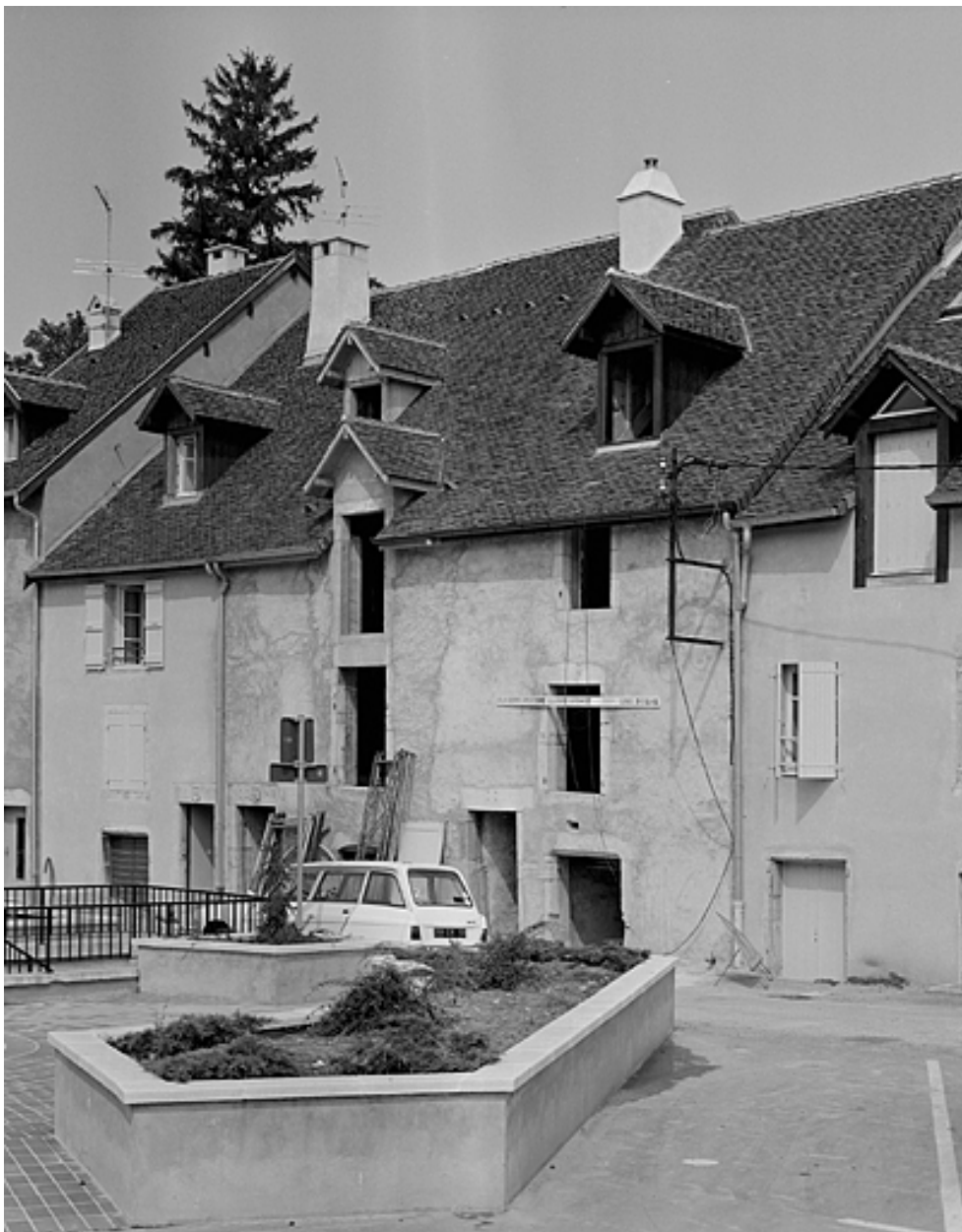
Façade antérieure avant réfection de l'enduit.
