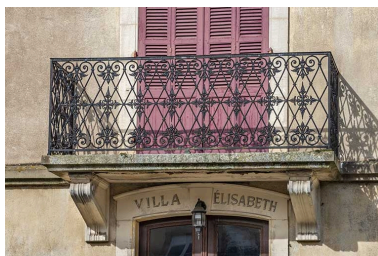
Façade sud, détail, balcon et inscription de la porte d'entrée. Phot. Jérôme Mongreville IVR43_20207000680NUC4A
