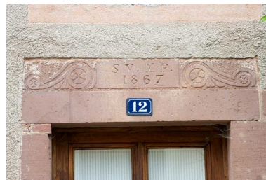
Détail de la façade antérieure : linteau de la porte d'entrée. Phot. Jérôme Mongreville IVR43_20102500641NUC4A
