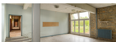
Salle de jeux à l'extrémité ouest de l'aile Bellevue. Phot. Pierre-Marie Barbe-Richaud IVR26_20195800087NUC4AQ
