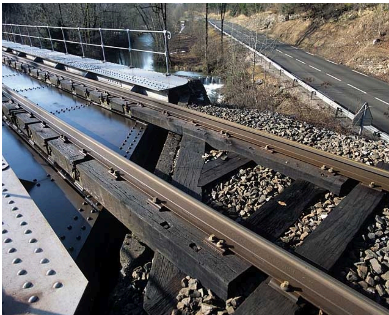
Pont sur la Lemme : jonction du tablier et de la culée droite, depuis la voie.
