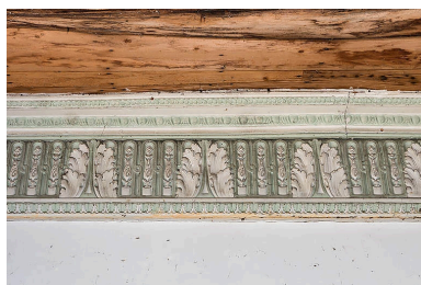
"Château neuf" : moulure dans la chambre à l'étage de la "Tour du Four". Phot. Pierre-Marie Barbe-Richaud IVR26_20222100111NUC4A
