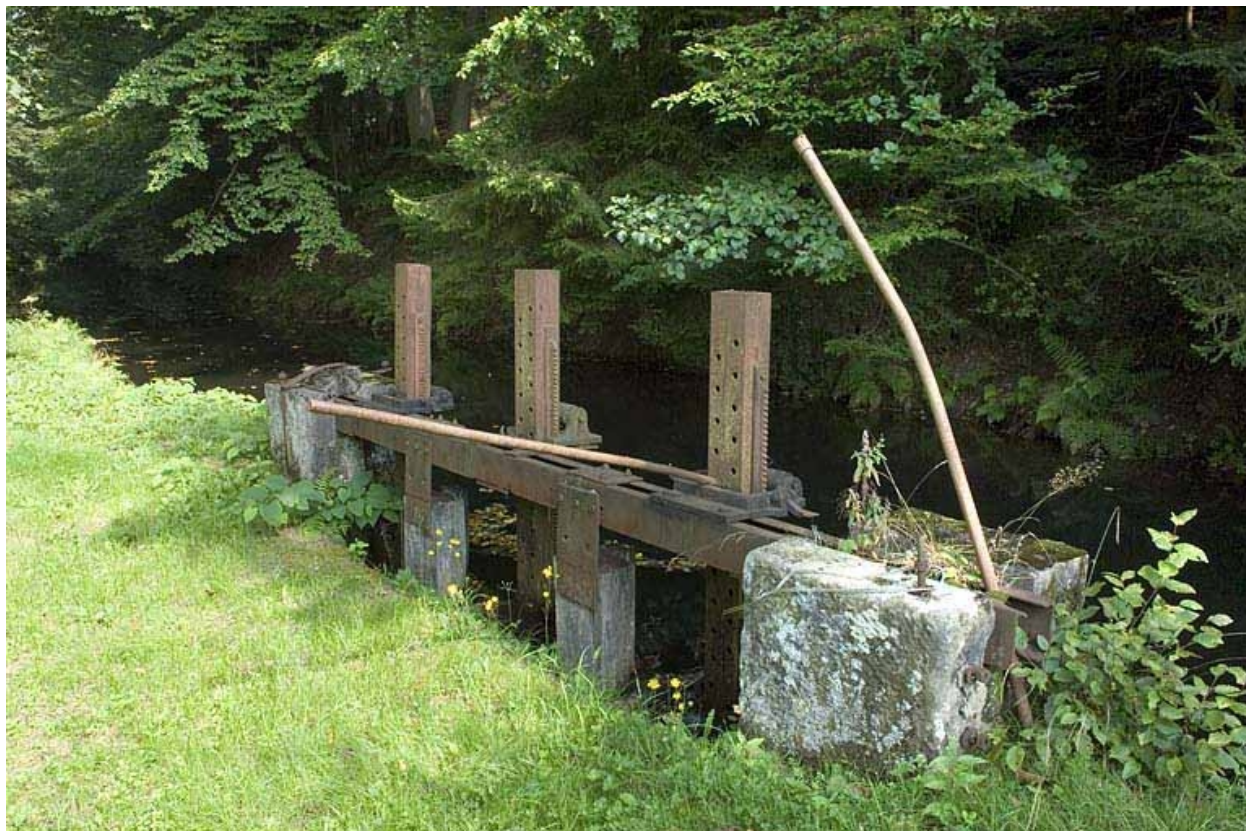
Vanne de décharge sur le bief d'amenée.
