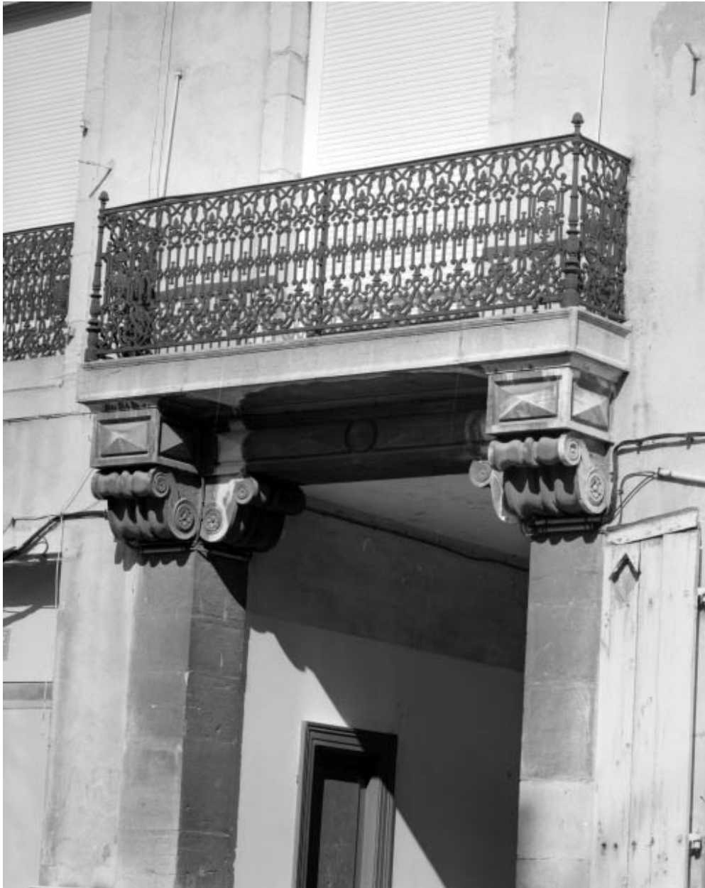
Façade postérieure du corps de logis sur cour, détail du balcon au-dessus de l'entrée cochère.
