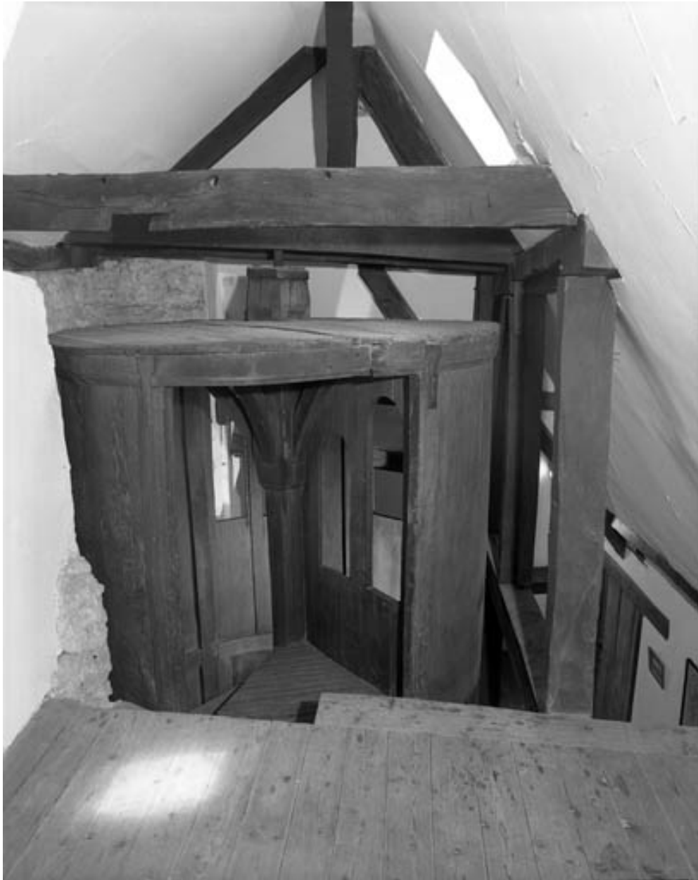
Sommet du cylindre depuis les combles avec le détail de la partie supérieure du noyau de l'escalier.
