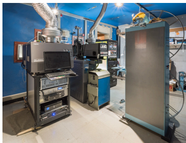
Vue d'ensemble de la cabine depuis le fond. Projecteur numérique Nec à gauche, projecteur argentique Simplex et redresseur Prevost au centre, enrouleur-dérouleur vertical Idef à droite. Phot. Pierre-Marie Barbe-Richaud IVR26_20257100375NUC4A
