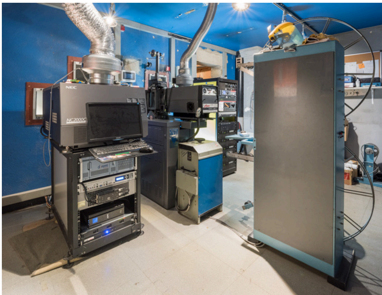
Vue d'ensemble de la cabine depuis le fond. Projecteur numérique Nec à gauche, projecteur argentique Simplex et redresseur Prévost au centre, enrouleur-dérouleur vertical Idef à droite.
