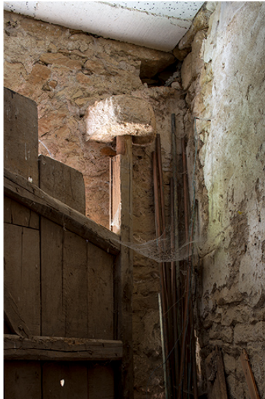
Détail du fonctionnement de la porte charretière : poteau- tourillon et crapaudine. Phot. Nicolas Waltefaugle IVR26_20258900152NUC4A
