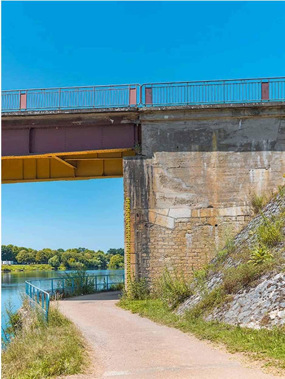
Culée rive droite du pont de Bragny. On lit les différentes phases de reconstruction de l'ouvrage.
