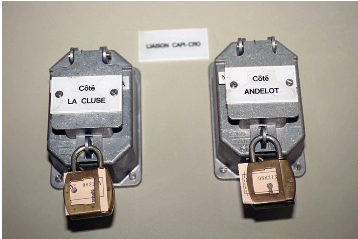
Commande manuelle du dispositif d'arrêt automatique des trains.
