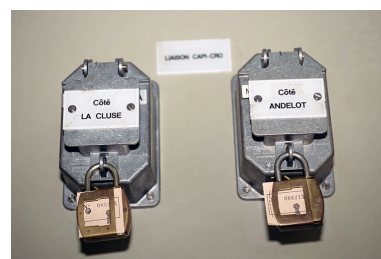
Commande manuelle du dispositif d'arrêt automatique des trains. Phot. Yves Sancey IVR43_20053900426ZA
