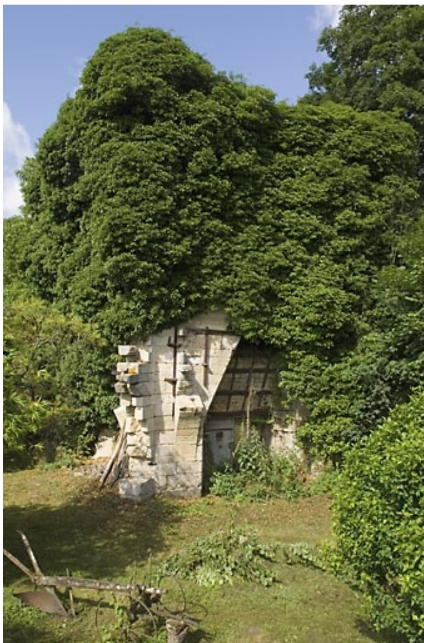
Etat du massif du haut fourneau.
