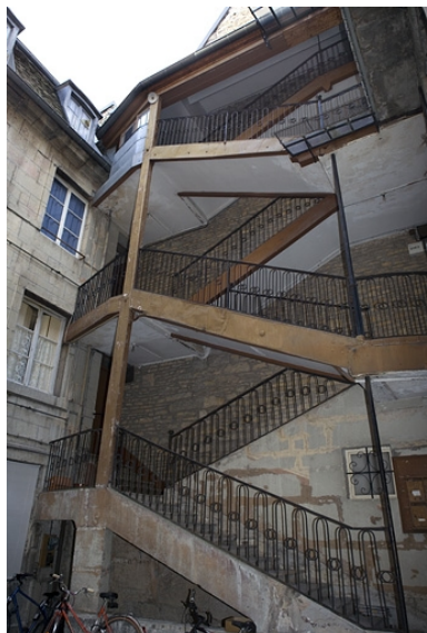
Vue d'ensemble de l'escalier à cage ouverte sur cour. Phot. Yves Sancey IVR43_20072500273NUCA
