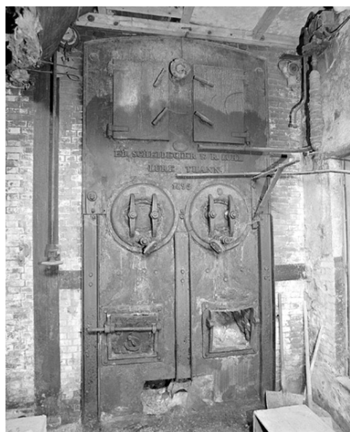
Chaudière de la machine à vapeur. Phot. Yves Sancey IVR43_19999000282X
