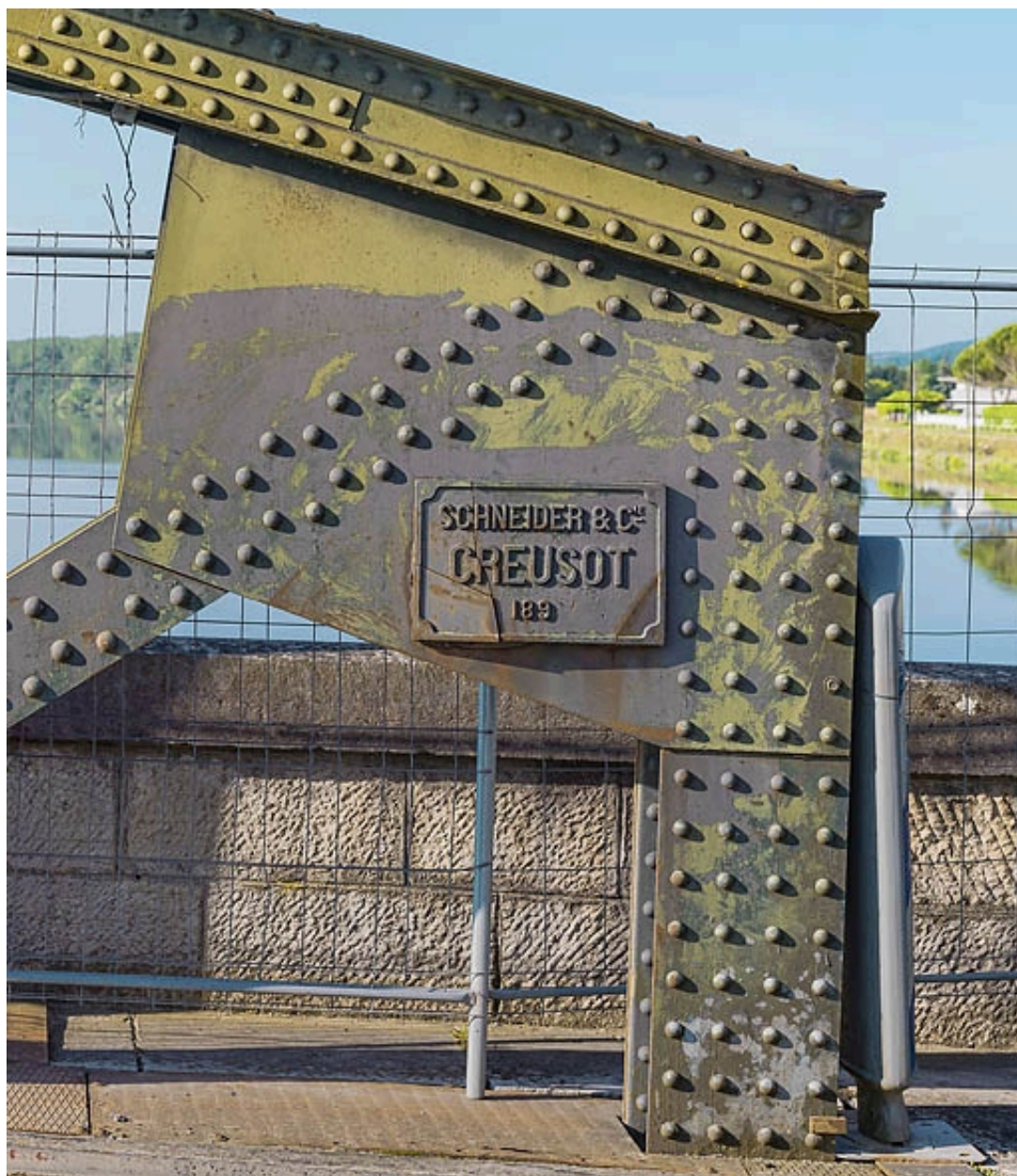
Détail de la structure métallique du pont et de la plaque "Schneider et Cie".
