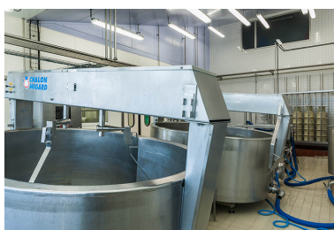
Détail : cuves. Phot. Jérôme Mongreville IVR43_20143900138NUC4A
