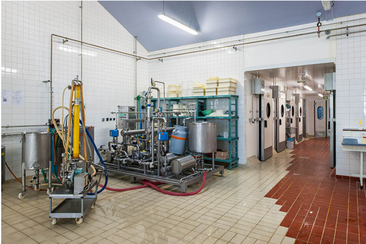
Salle de production des produits frais et accès aux chambres froides.
