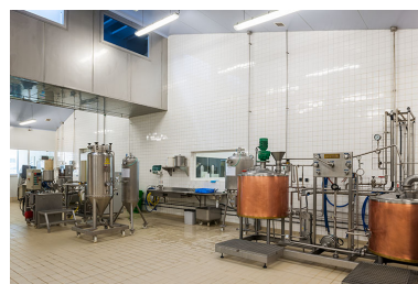
Salle de production des produits frais. Phot. Jérôme Mongreville IVR43_20143900132NUC4A
