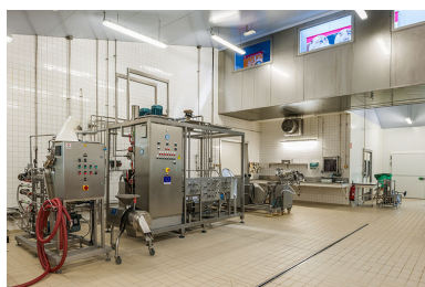
Salle de production des produits frais. Phot. Jérôme Mongreville IVR43_20143900133NUC4A
